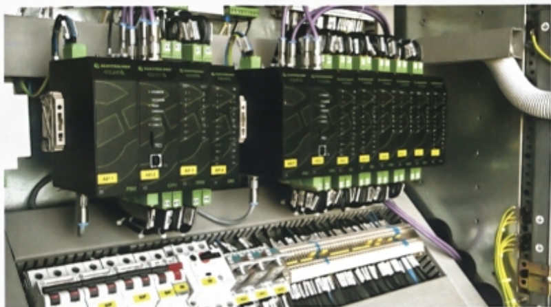
Automatyk CZAT 6 w polu wyłącznika rezerwowego rozdzielni prądu stałego
