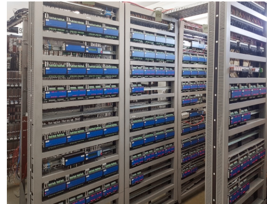
Stojaki systemu BUSZ-SRK-CZAT3000plus z zabudowanymi sterownikami mikroprocesorowymi CZAT3000plus
