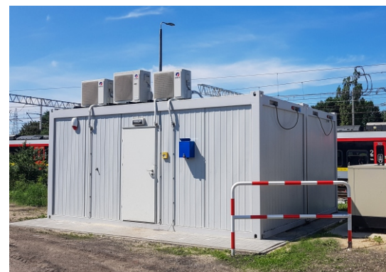
Kontener systemu ISKRA, stacja Zgierz
