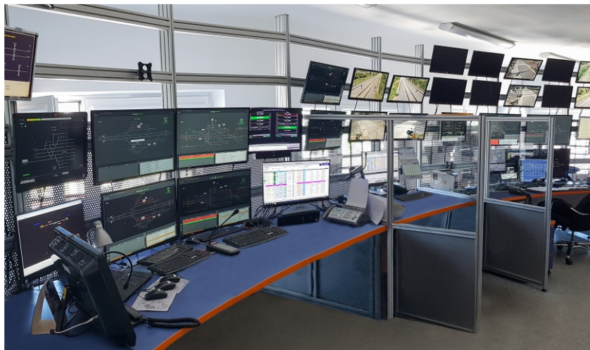
Stanowiska Dyżurnych Ruchu w LCS - system ISKRA
