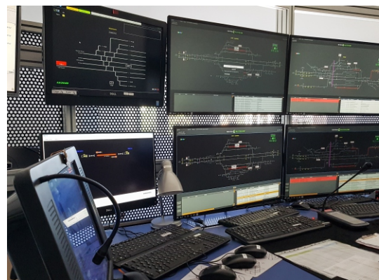
Stanowisko Dyżurnego Ruchu z systemem ISKRA obsługującego stację Łódź Żabieniec i Zgierz
