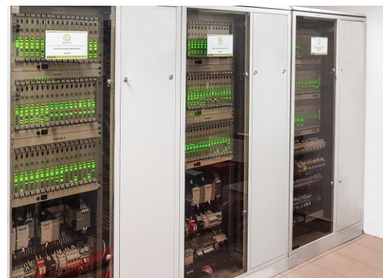
System ISKRA - Szafy komputerów wykonawczych wraz z kartami sterowników obiektowych
