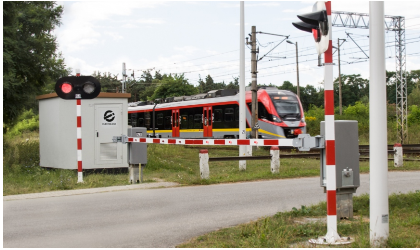
Przejazd kolejowo-drogowy kat. B wraz z kontenerem systemu PERUN
